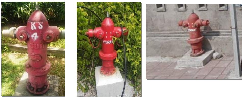
Gambar 3.6. Hidran di Jalan Siligita, Hidran Depan Banjar Sawangan, dan Hidran di Desa Kutuh
